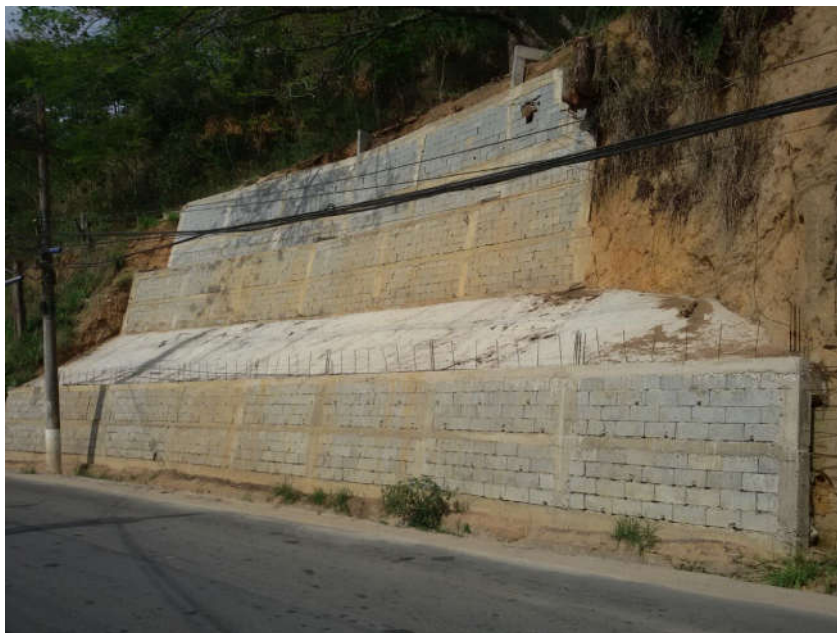
Figura 34 – Outro exemplo de solução precária de contenção com grande desperdício de recurso, Etr. Mineira Corrêas, 2º Distrito.
