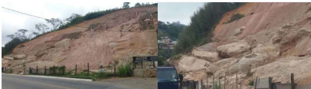
Figuras 42 e 43 – Terraplenagem mal planejada, mal controlada e mal executada, relegada ao abandono pelo proprietário do terreno. Etr. União e indústria, Nogueira, Itaipava, 3º Distrito.
