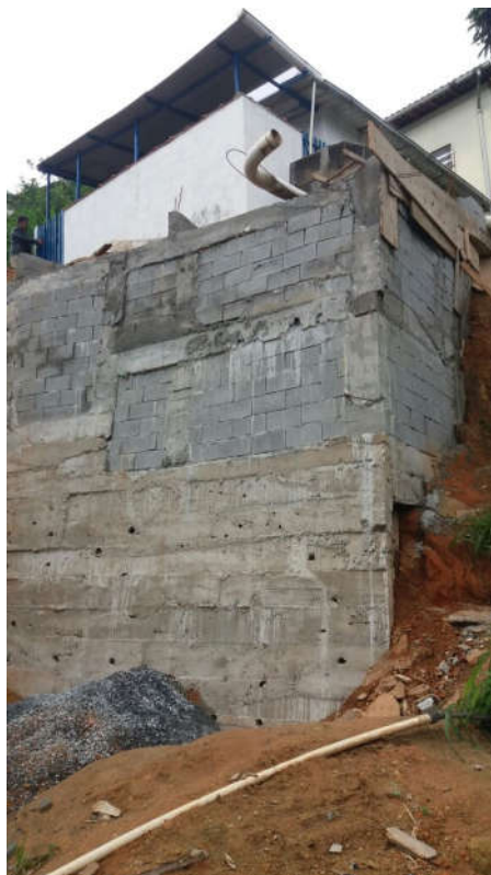
Figura 33 – Exemplo precariedade de “obra de contenção”, Rua Lopes de Castro, Valparaíso, 1º Distrito
